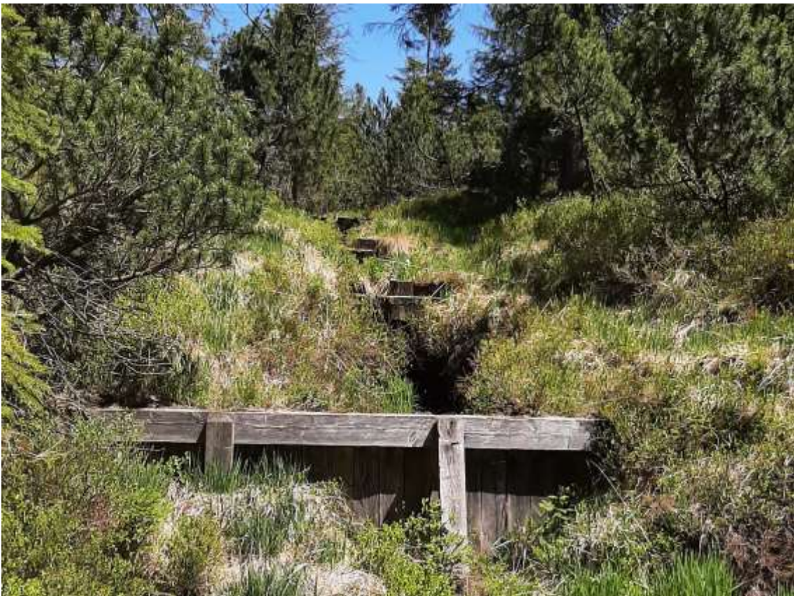
Abb. 10: Kleiner Kranichsee: Querverbauung zur Wasserrückhaltung am Südrand des Moores. (Foto: R. KÜTTNER, 30.05.2023)
